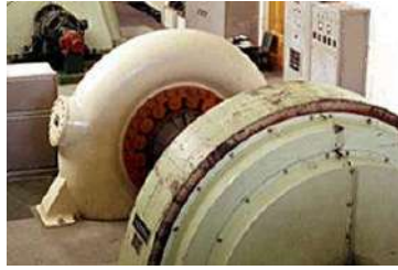
Conjunt alternador turbina d'una central hidroelèctrica
